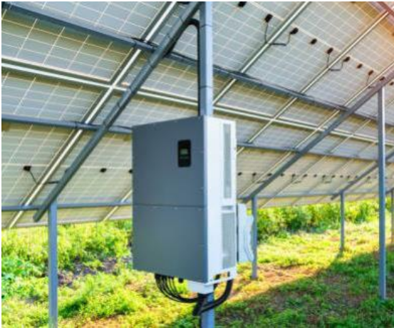
Figur 7. Exempelbild av strängväxelriktare monterat på solpanelstativ. Fotografiet tillhör ©Rabbalshede Kraft AB.
